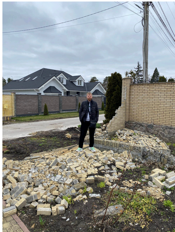
Руйнування в пансіонаті
